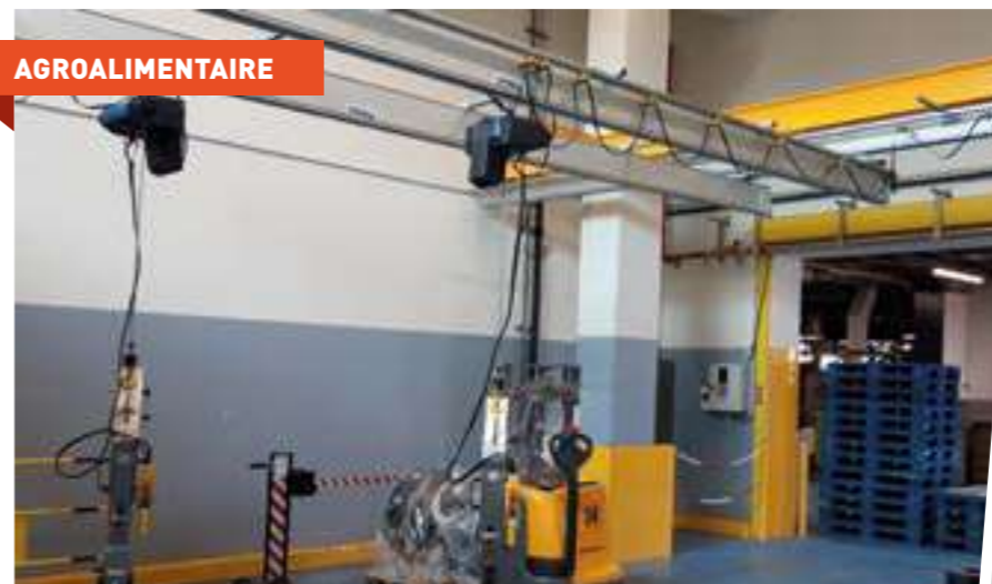
Portique et poutre roulante
